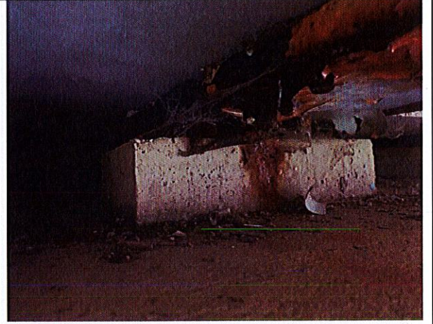
Intrados tablier / sommier : Corrosion feuilletante des semelles inférieures en about de poutres métalliques enrobées
