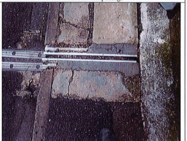
Joints de trottoirs : Décollement et fractures sur les solins bétons
