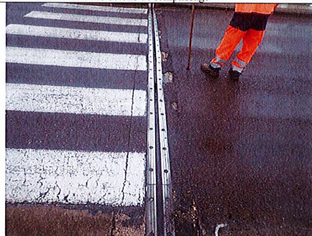
Joints de chaussée : Eclats sur solin bétons
