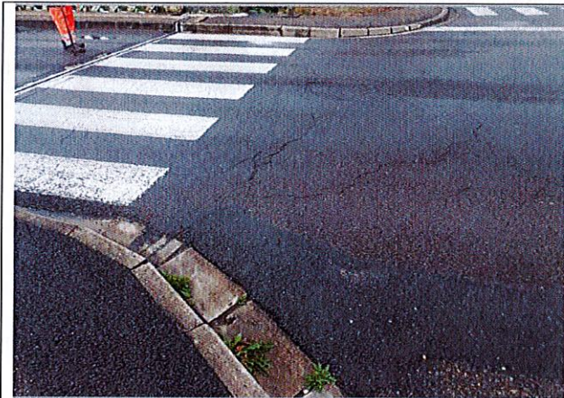
Chaussée : fissurations longitudinales en about d'ouvrage
