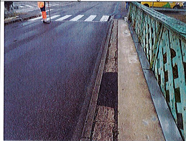
Trottoir : Erosion des bétons de remplissage
