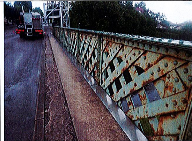
Garde-corps/poutres latérales : Piqûres de rouille et corrosion généralisées
