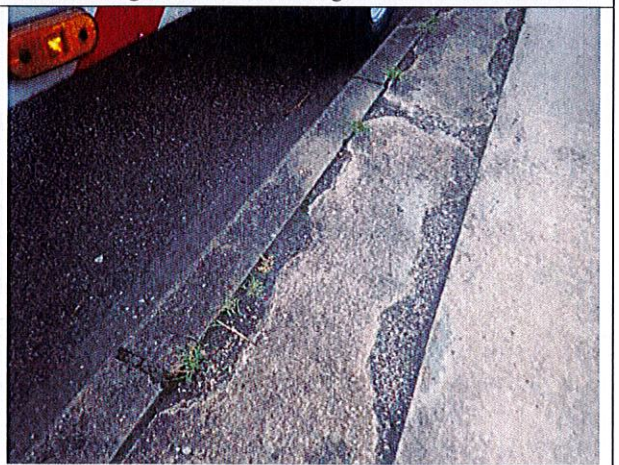
Trottoir : Erosion des bétons de remplissage
