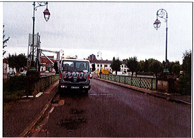
Chaussée : léger tassement avec stagnation d'eau sur chaussée
