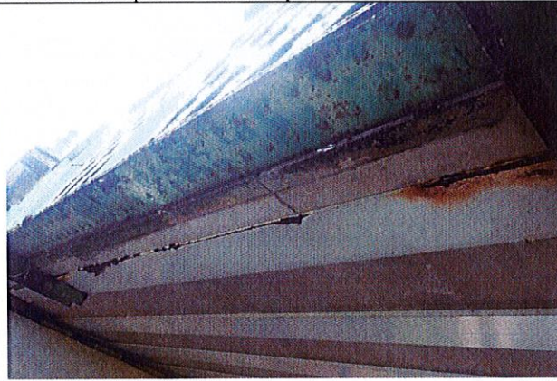
Intrados tablier : Ecaillage de peinture avec corrosion de la semelle inférieure des poutres métalliques enrobées
